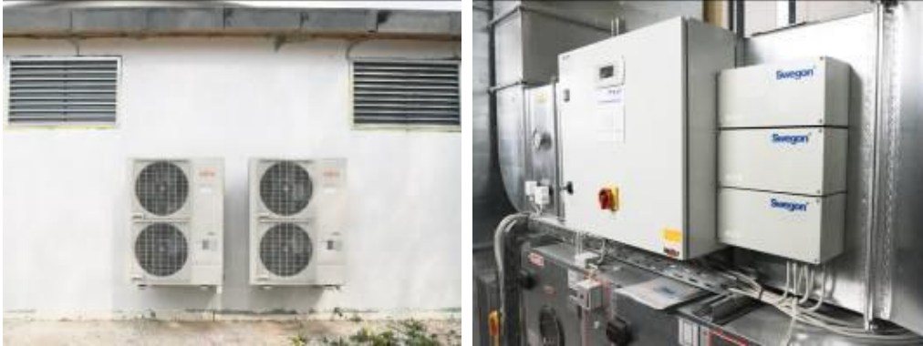
Die beiden Fujitsu-Außeneinheiten für die Klimatisierung der Trainingshalle, darüber Zu- und Abluftgitter des RLT-Geräts. Daran befestigt sind die drei Steuereinheiten INV-DX für die Außengeräte.
