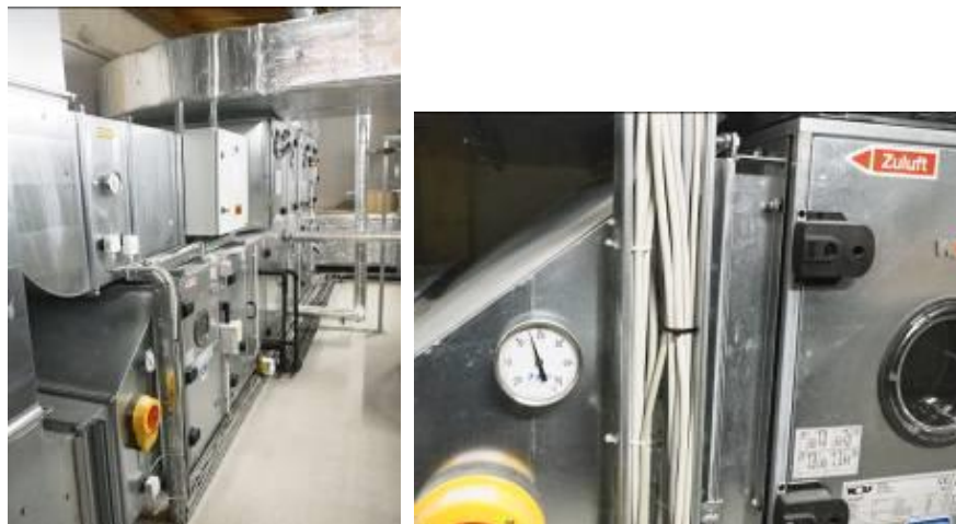
Der Blick in den neuen Technikraum. Die Zulufttemperatur liegt vor dem Einblasen in das Wickelfalzrohr zur Klimatisierung der Trainingshalle bei 15°C.
